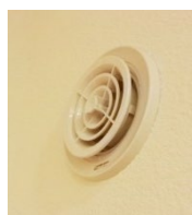
開放して換気を行います。寒い場合は開閉しながら温度調整します。
